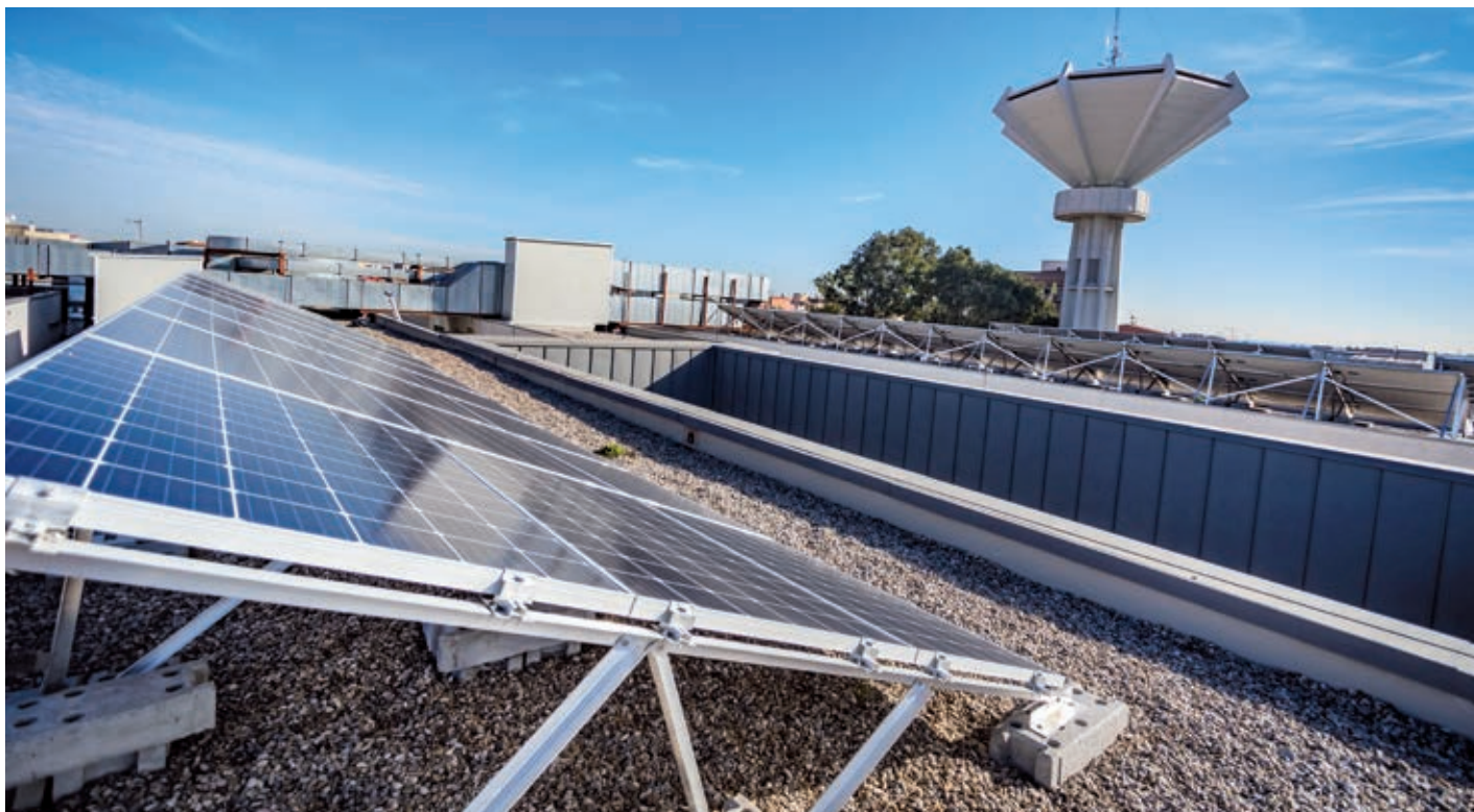
Plaques fotovoltaïques a la coberta del Cèntric Espai Cultural.
